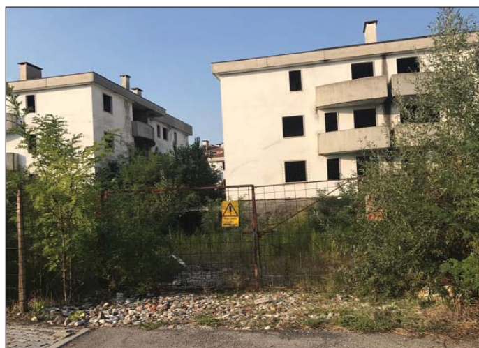
I fatiscanti palazzoni a Cavalcaselle
