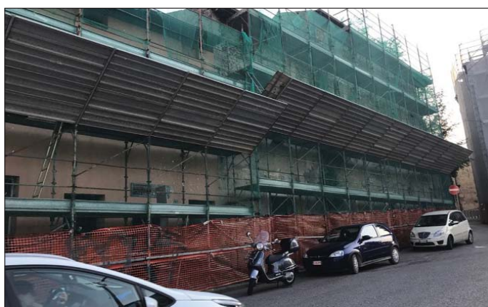
Cavalcaselle: il degrado dell'ex Albergo Italia
