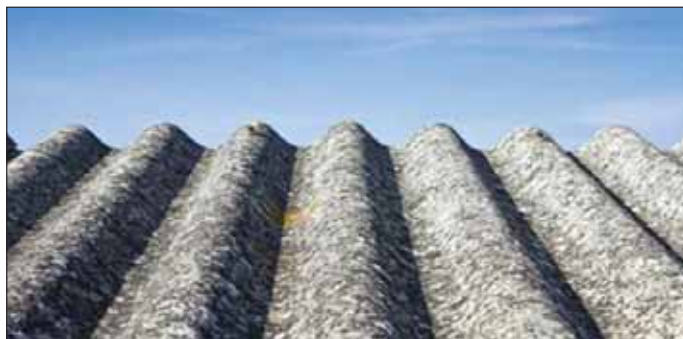
Una copertura in amianto: la pericolosità di questo materiale è ormai ben nota
